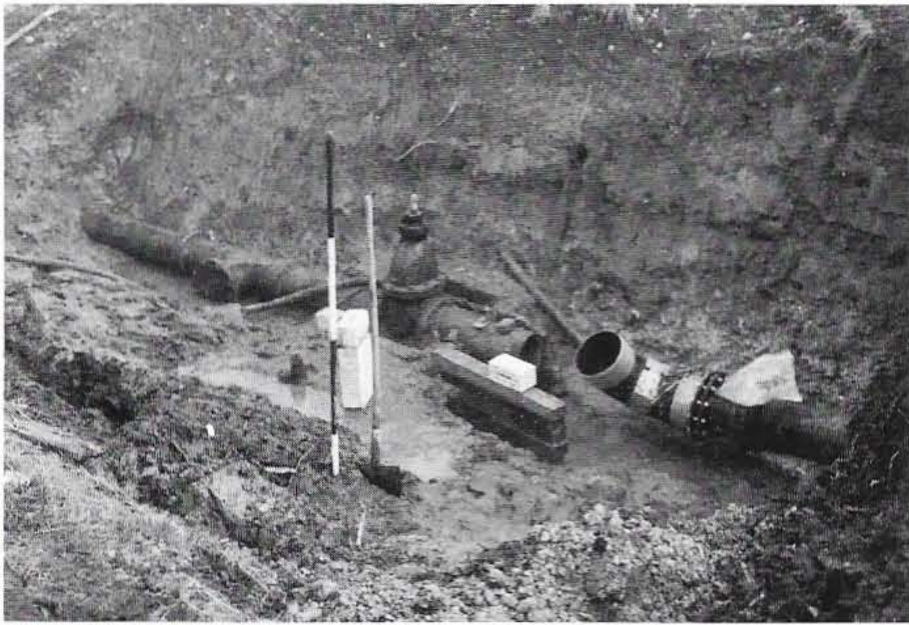
Bild 22. Freigelegte, 110 Jahre alte Druckleitung des Äusseren Weihers, bestehend aus Graugussrohren mit Stammhülsen. Die Leitung wurde kurz oberhalb des im Bild sichtbaren Schiebers unterbrochen und das obere Teilstück als Grundablass ausgebildet. Durch den neu angebrachten Rohrbogen kann der Weiher bei Bedarf direkt in den nahegelegenen Kringelbach abgelassen werden
