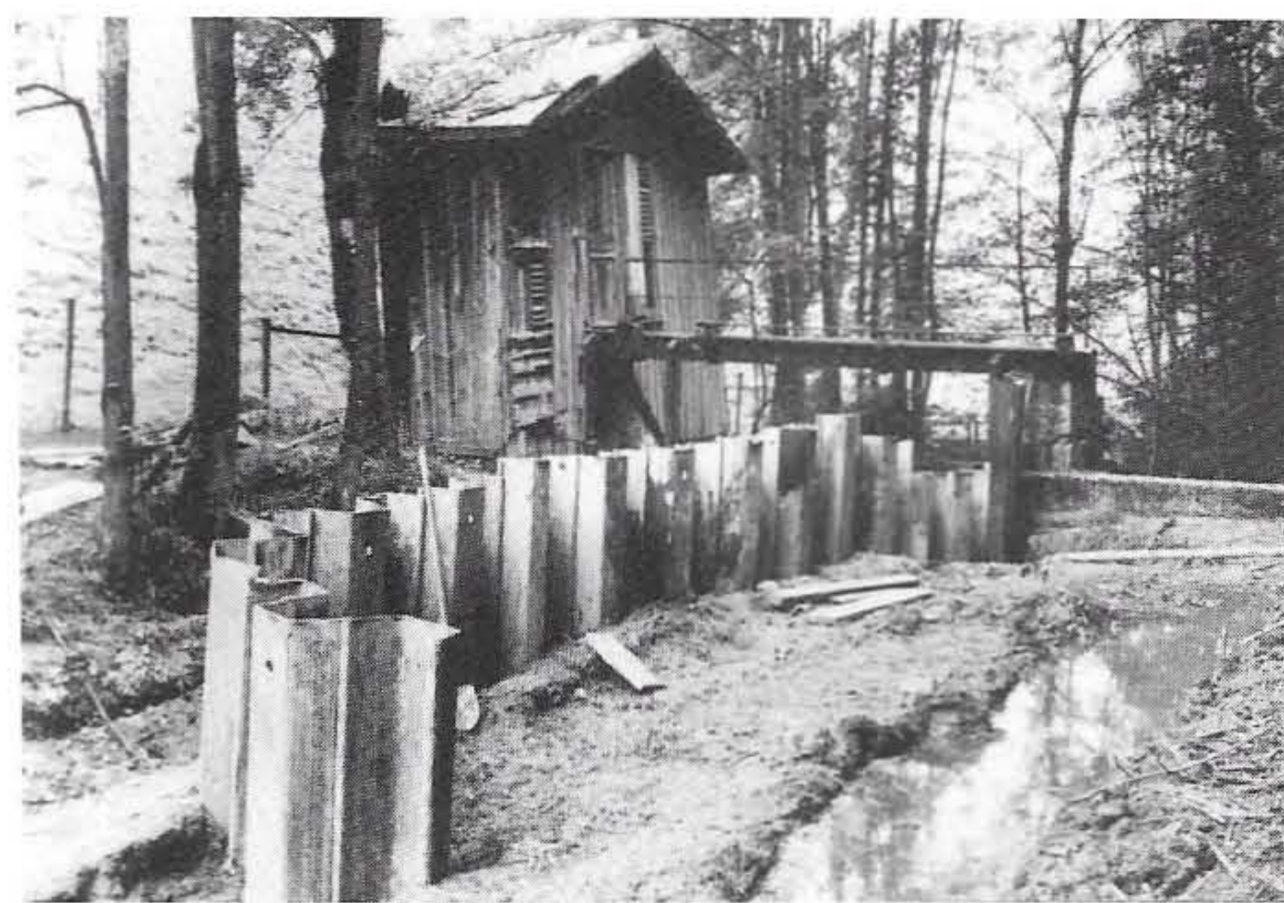
Bild 12. Das durch das Hochwasser 1977 teilweise zerstörte Obere Wehr mit der zum Schutze der Quellfassungen geschlagenen Spundwand 1977 (Bild der Wasserversorgung Wetzikon).
